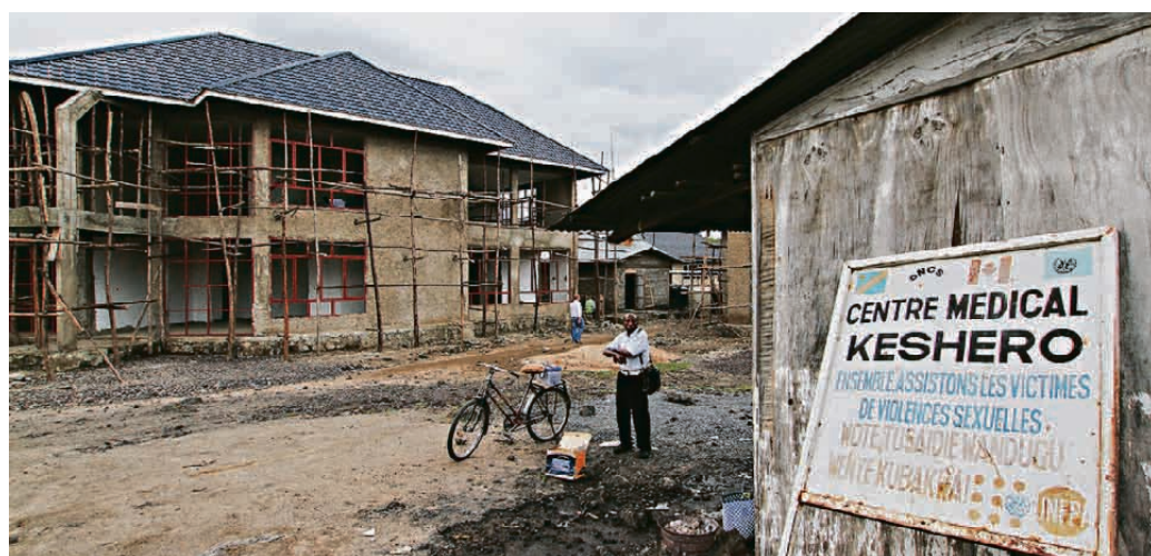
Et stort sykehus er under bygging på lavajordet i Goma, finansiert med norske bistandsmidler. FOTO: JAN SPEED
