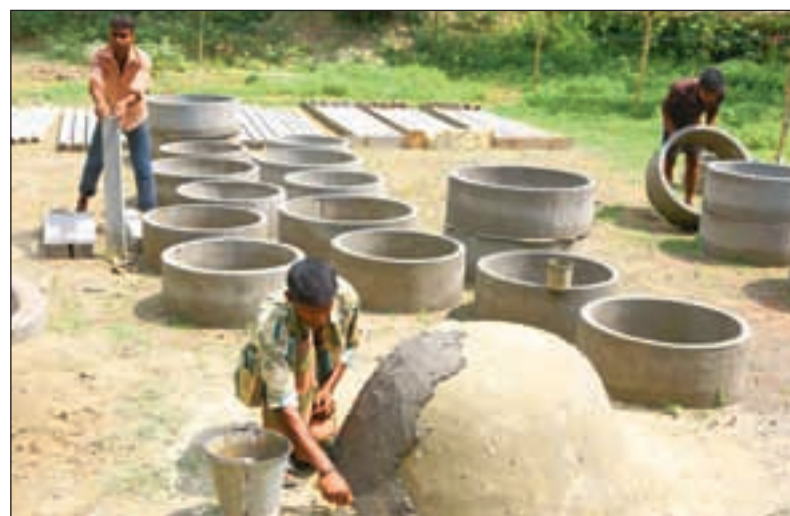
Små septiktanker har forbedret sanitærsituasjonen i landsbyen.
