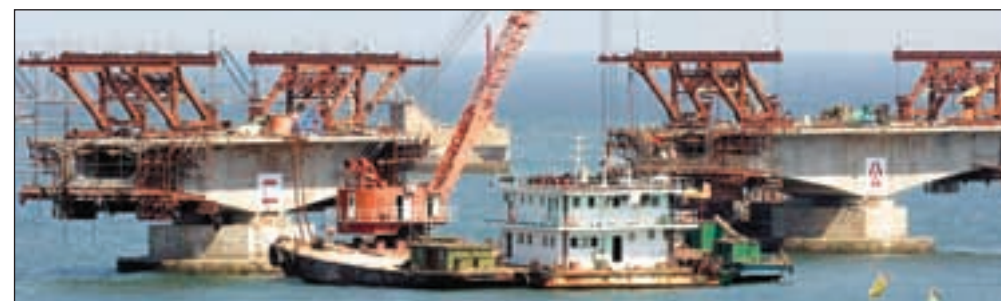
Byggearbeidene er i gang på det som skal bli verdens største oljeterminal i den kinesiske byen Quingadao.
