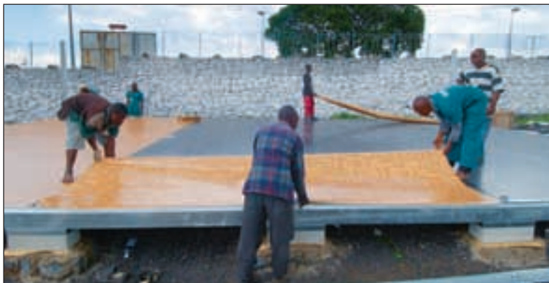
Inne på FN-styrkens base i Goma, finner man et sjeldent eksempel på at valgforberedelsene er i gang: byggingen av et provisorisk stemmelokale.
