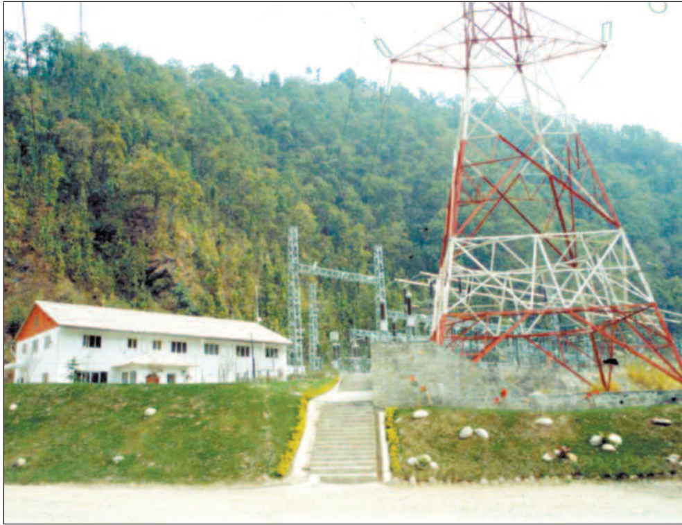
Kontrollrom, kommunikasjonsutstyr og bolighus ved Khimti-anlegget ble ødelagt som følge av maoistenes angrep.
