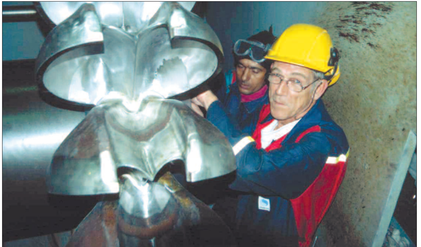
I mange år fremover vil norske ingeniører lære opp de lokalt ansatt ved Khimti-kraftverket. Her er Odd Arne Andresen, som er utlånt fra Statkraft, i ferd med å drille Krisna Prasad Phuyal om viktigheten av vedlikehold. ALLE FOTO: BIBIANA DAHLE PIENE
